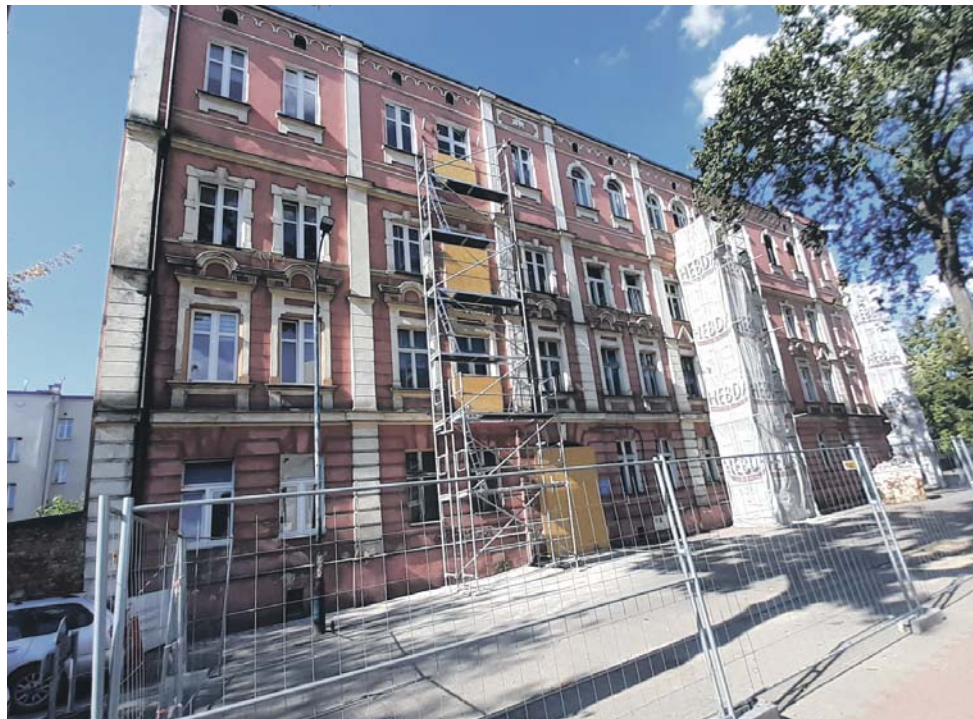
Kamienica przy ul. Czystej wciąż jest zabezpieczona barierkami.
